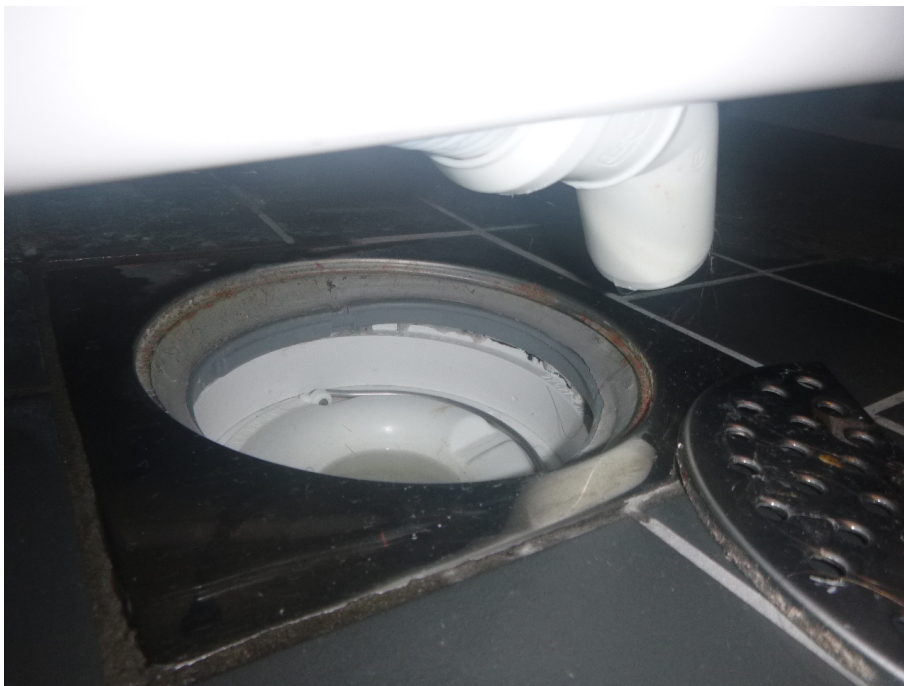
Klämring i golvbrunn, badrum.
