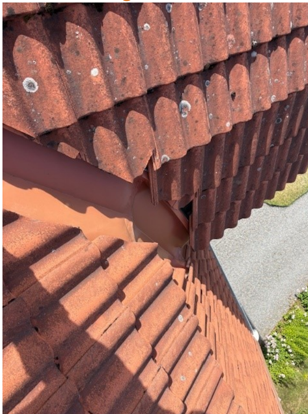
Trasiga takpannor/otätheter vid rännål.
