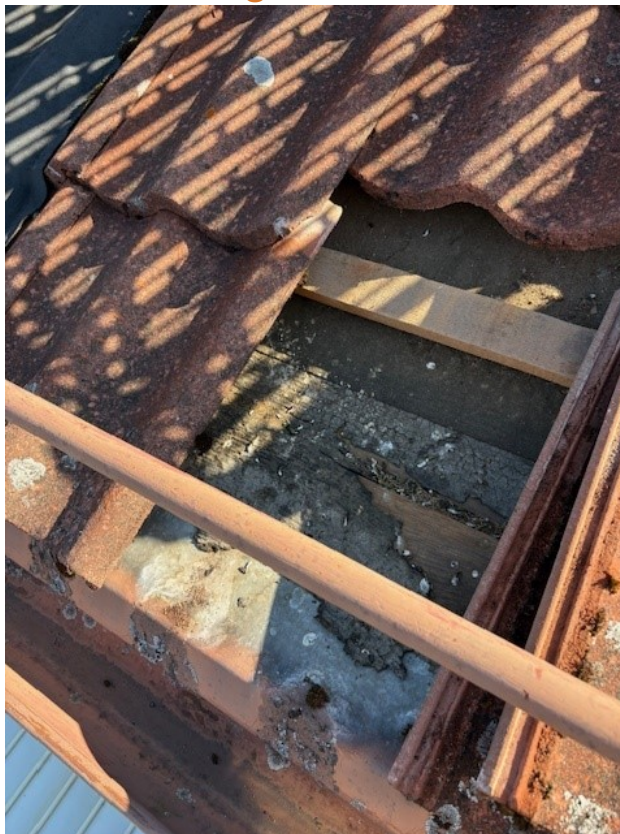
Äldre/bristfällig takpapp under den nedre pannraden.
