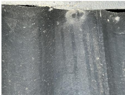
Foto visar glipa mellannock- och takpannor.
