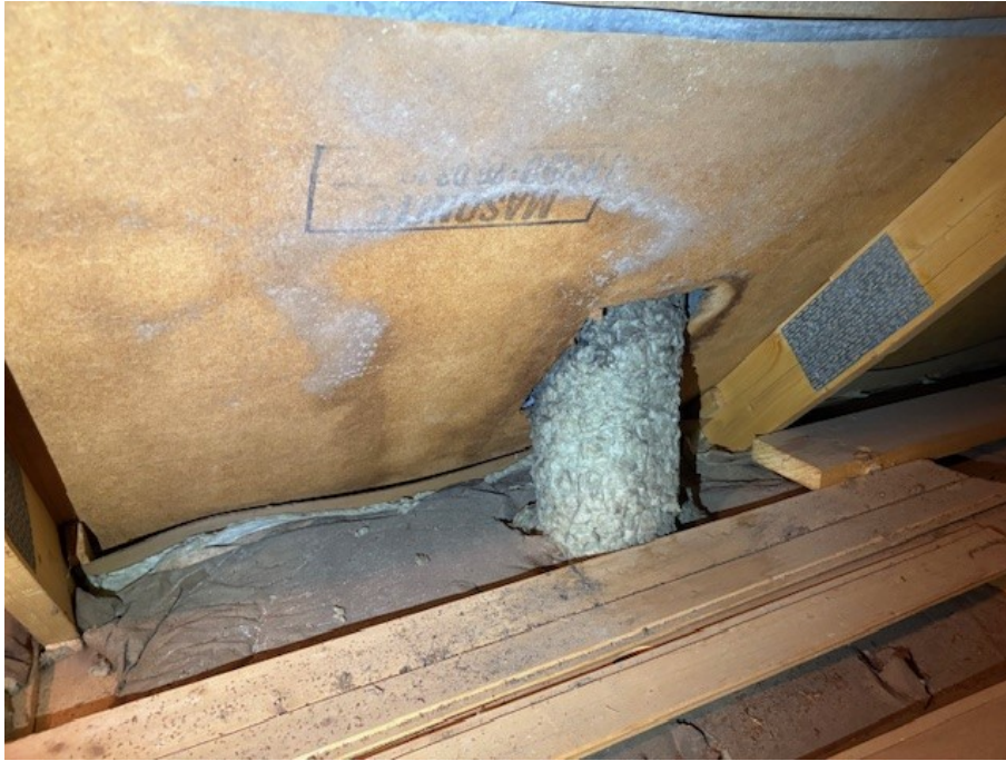
Fuktfäckar kring ventilationsgenomföring på vind.
