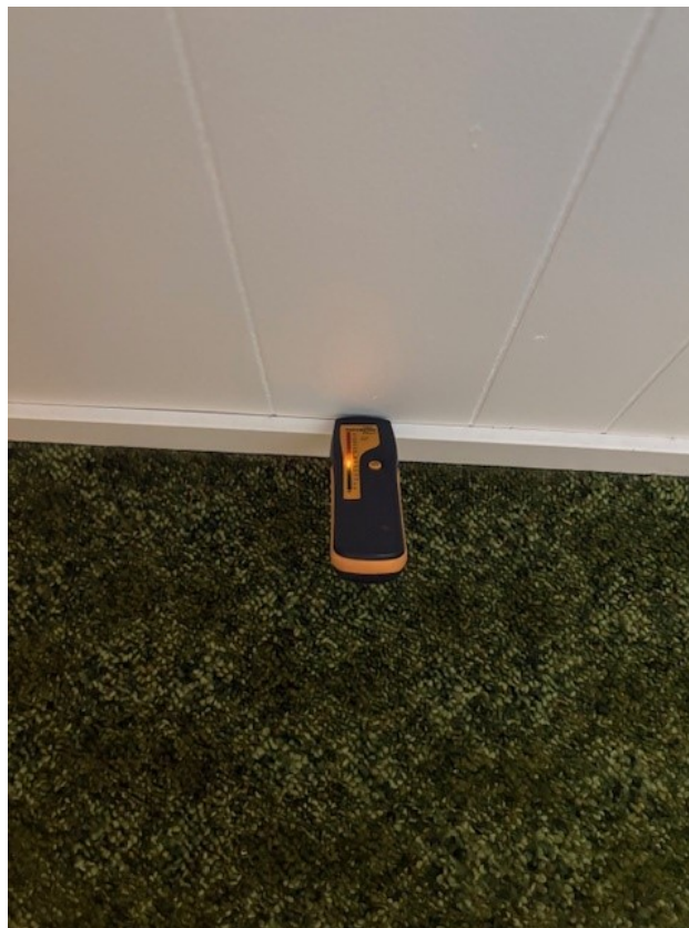
Fuktmätning i utreglad vägg i källaren, något förhöjda fuktvärden uppmättes.
