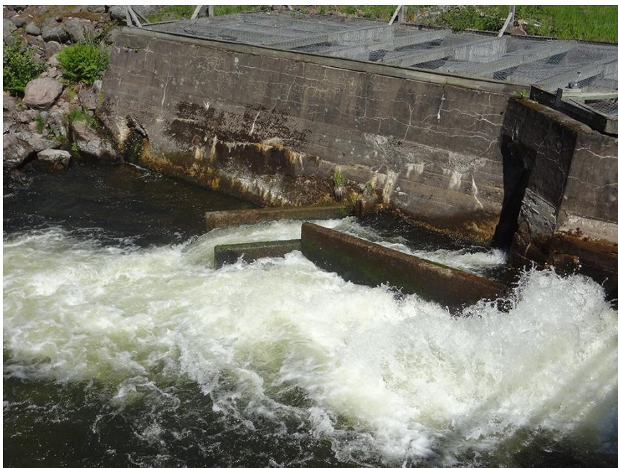
Figur 56. Nedre delen av bassängtrappan i Laxberg. Smolten ska simma/hoppa in i trappan mot en relativt hög vattenhastighet. Övrig tappning från dammen släpps intill fiskvägen för att öka anlockningen.
