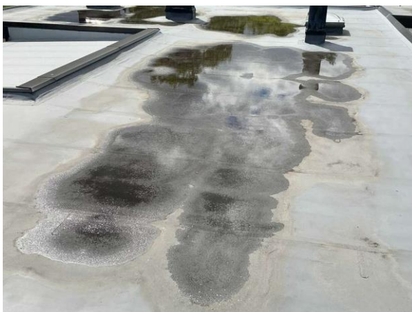
Bild 2: - Utvändigt, Yttertak, Färgsläpp på takfot noterades Invändig takavattning är en sk riskkonstruktion Vatten står i pöla...
