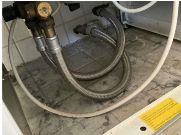
Bild 29: - Invändigt, Entréplan, Äldre våtrum se riskanalysen Golvbrunnen är lågt placerad Det förekommer rörgenomföringar i golv ...
