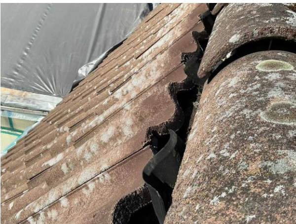
Bild 18: - Utvändigt, Yttertak, Äldre tak besiktat från taksäkerhet Rötskador i vindskivor Missfärgningar på tak saknas över takk...
