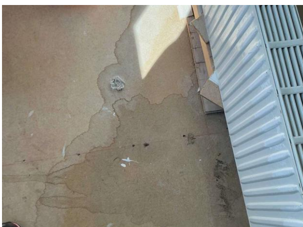
Bild 34: Invändigt, Övervåning, Fuktskada på golv noterades oklart hur det uppstått
