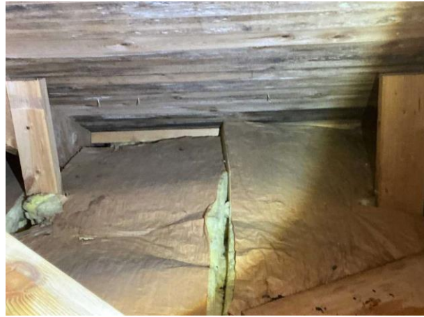
Bild 15: - Utvändigt, Vind, Parallellisolerade /snedtak se riskanalysen Hål i plastfolie noterades Missfärgad isolering not...
