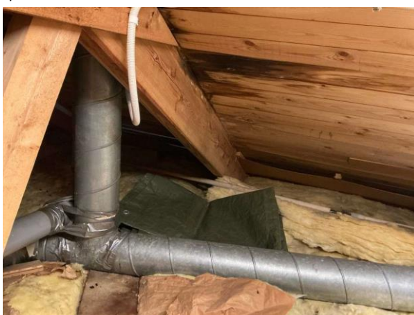
Bild 13: - Utvändigt, Vind, Parallellisolerade /snedtak se riskanalysen Hål i plastfolie noterades Missfärgad isolering not...
