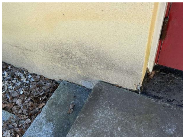
Bild 4: - Utvändigt, Fasad, Sk enstegstätad fasad luftspalt saknas mot bakomliggande trästomme Sprickor och Sk bomputs notera...
