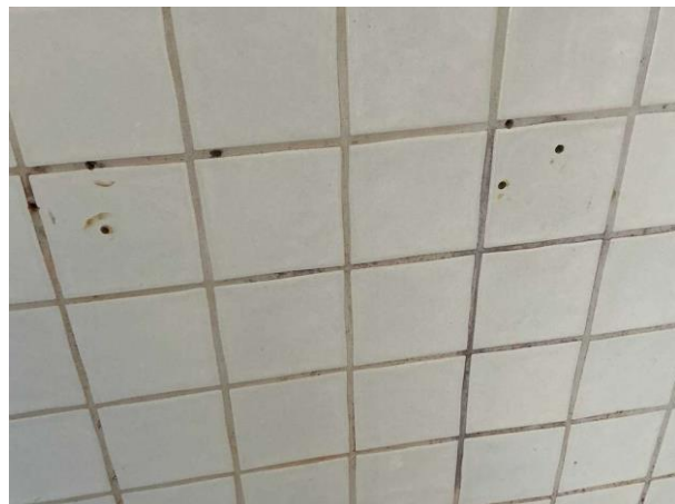
Bild 31: - Invändigt, Entréplan, Äldre våtrum se riskanalysen Golvbrunnen är lågt placerad Det förekommer rörgenomföringar i golv ...
