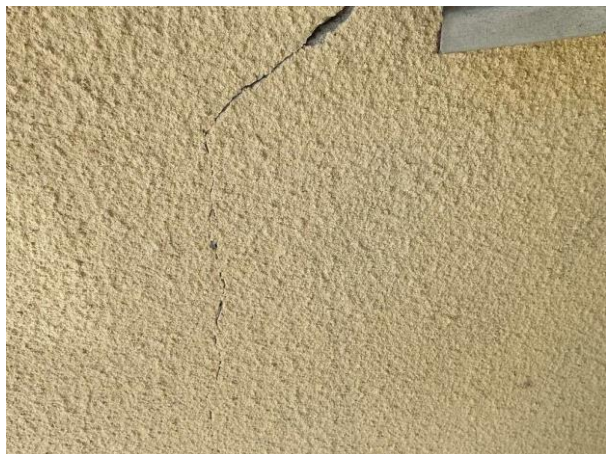
Bild 2: - Utvändigt, Fasad, Sk enstegstätad fasad luftspalt saknas mot bakomliggande trästomme Sprickor och Sk bomputs notera...
