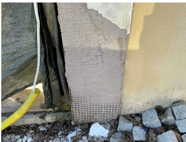
Bild 5: - Utvändigt, Fasad, Sk enstegstätad fasad luftspalt saknas mot bakomliggande trästomme Sprickor och Sk bomputs notera...
