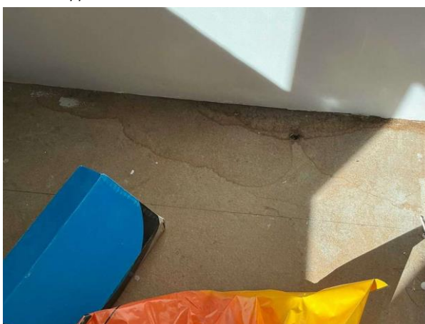
Bild 35: Invändigt, Övervåning, Fuktskada på golv noterades oklart hur det uppstått
