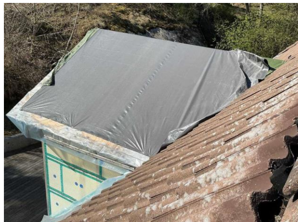
Bild 19: - Utvändigt, Yttertak, Äldre tak besiktat från taksäkerhet Rötskador i vindskivor Missfärgningar på tak saknas över takk...
