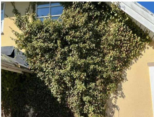
Bild 3: - Utvändigt, Fasad, Sk enstegstätad fasad luftspalt saknas mot bakomliggande trästomme Sprickor och Sk bomputs notera...
