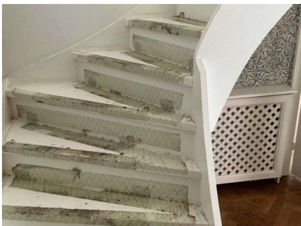
Bild 32: Invändigt, Övervåning, Räcke saknas (fallrisk)
