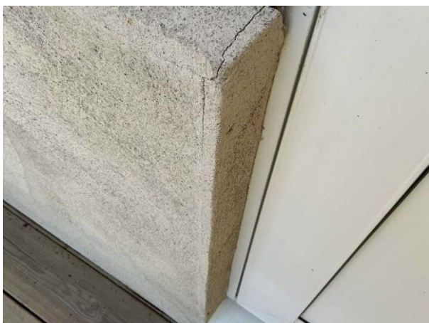
Bild 8: - Utvändigt, Fasad, Sk enstegstätad fasad luftspalt saknas mot bakomliggande trästomme Sprickor och Sk bomputs notera...
