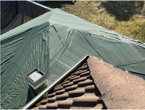
Bild 20: - Utvändigt, Yttertak, Äldre tak besiktat från taksäkerhet Rötskador i vindskivor Missfärgningar på tak saknas över takk...
