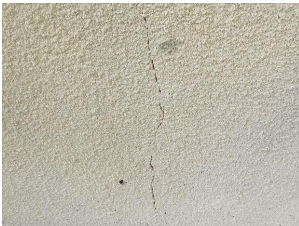
Bild 1: - Utvändigt, Fasad, Sk enstegstätad fasad luftspalt saknas mot bakomliggande trästomme Sprickor och Sk bomputs notera...
