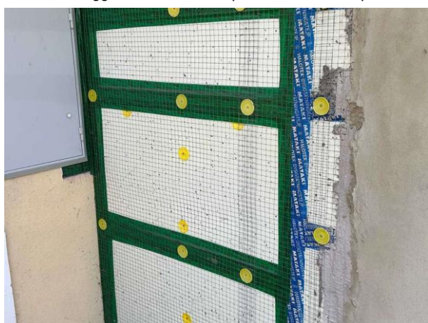
Bild 6: - Utvändigt, Fasad, Sk enstegstätad fasad luftspalt saknas mot bakomliggande trästomme Sprickor och Sk bomputs notera...
