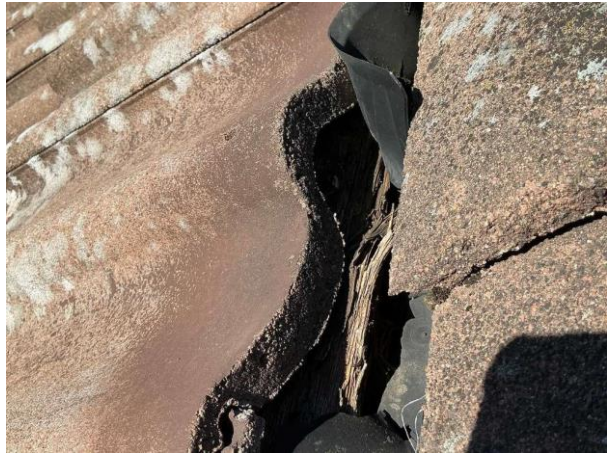
Bild 21: - Utvändigt, Yttertak, Äldre tak besiktat från taksäkerhet Rötskador i vindskivor Missfärgningar på tak saknas över takk...
