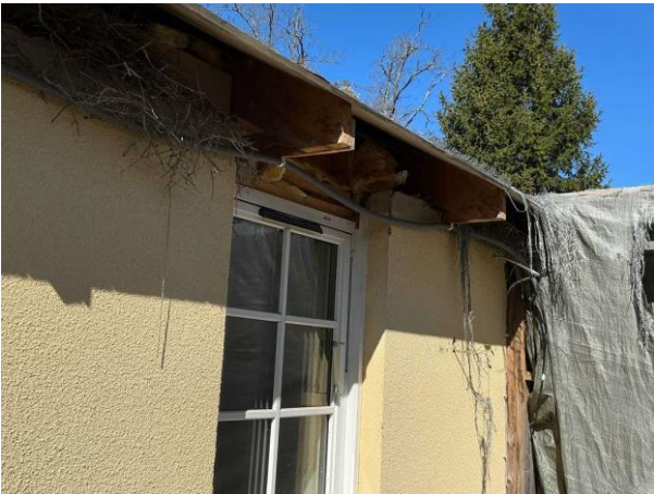
Bild 22: - Utvändigt, Tillbyggnad, Påbörjad tillbyggnad Gjuten betongplatta oskyddad mot regn Lös puts på vägg mor bef byggnad St...
