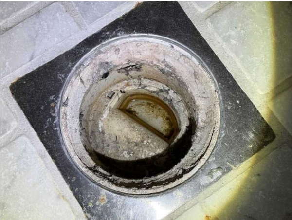
Bild 28: - Invändigt, Entréplan, Äldre våtrum se riskanalysen Golvbrunnen är lågt placerad Det förekommer rörgenomföringar i golv ...
