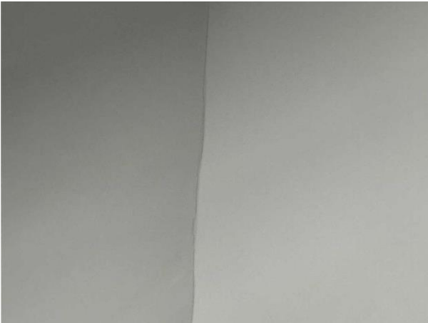
Bild 26: - Invändigt, Entréplan, Sprickor i skivskarvar tak Skivgolv ej fackmannmässigt läggning
