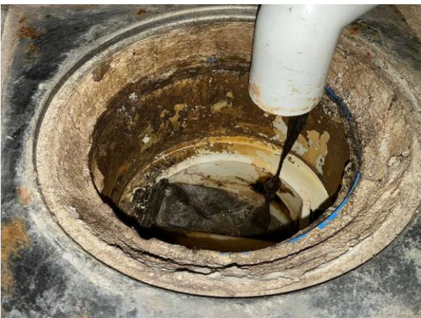
Bild 30: - Invändigt, Entréplan, Äldre våtrum se riskanalysen Golvbrunnen är lågt placerad Det förekommer rörgenomföringar i golv ...
