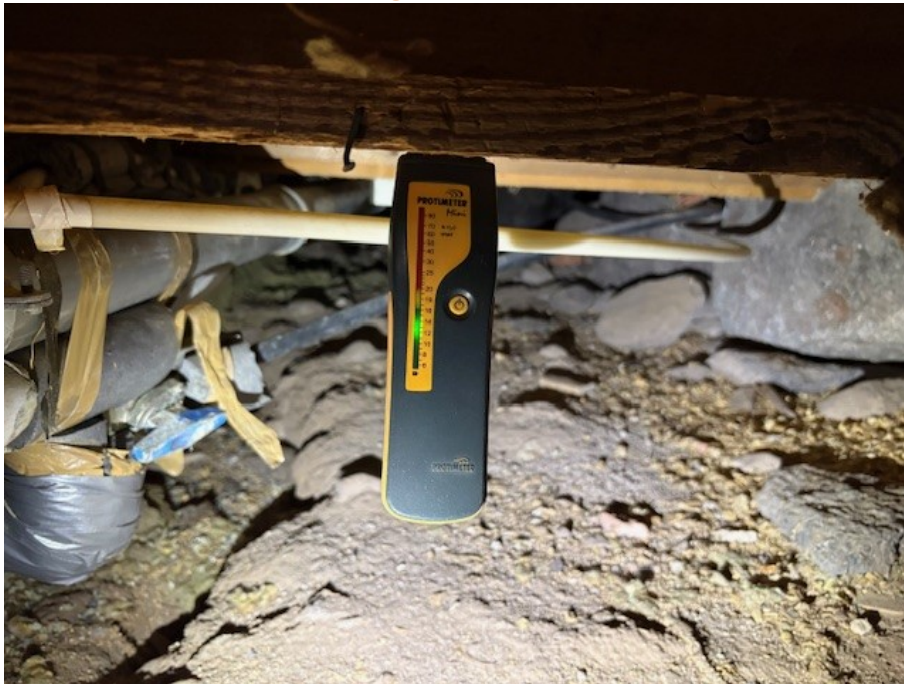
Fuktmätning i torpargrunden via lucka i vardagsrummet.
