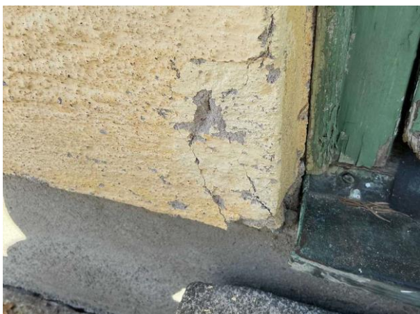
Bild 1: - Utvändigt, Fasad, Sprickor och lös puts noterades på fasaden Underhållsbehov föreligger på delar av fasaden
