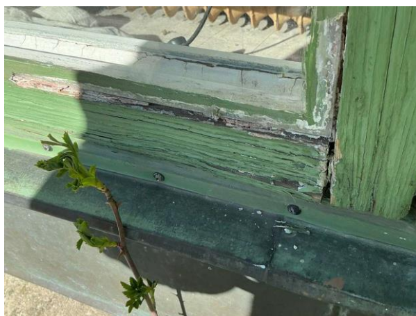
Bild 4: - Utvändigt, Fönster, Torrspäckor, färgsläpp och kittsläpp på fönster Röttskada i karmbottenstycke noterades baksidan b...
