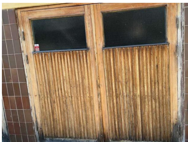
Bild 6: Utvändigt, Ytterdörr, Källardörr och garageport har underhållsbehov
