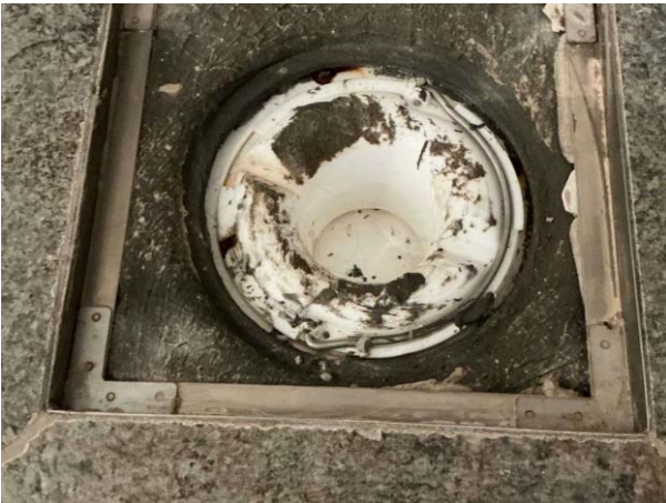
Bild 15: - Invändigt, Källarplan, Renoverat 2026. Tätskikt monterat över klämring. Kvalitetsdokument saknas.
