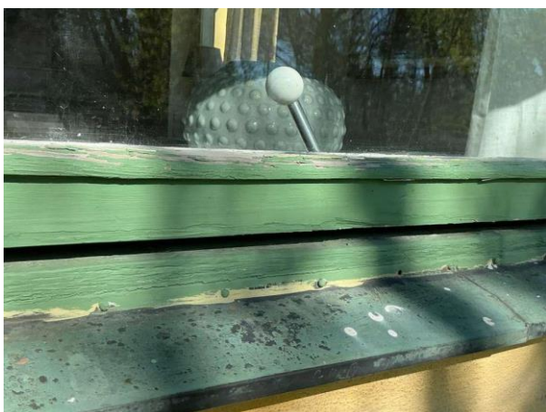
Bild 3: - Utvändigt, Fönster, Torrspäckor, färgsläpp och kittsläpp på fönster Röttskada i karmbottenstycke noterades baksidan b...
