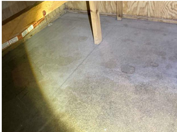
Bild 16: - Invändigt, Källarplan, Äldre standard utan tätskikt på golv. Träskiva mot betonggolv. Utförd utan golvbrunn. Se riskanalysen.
