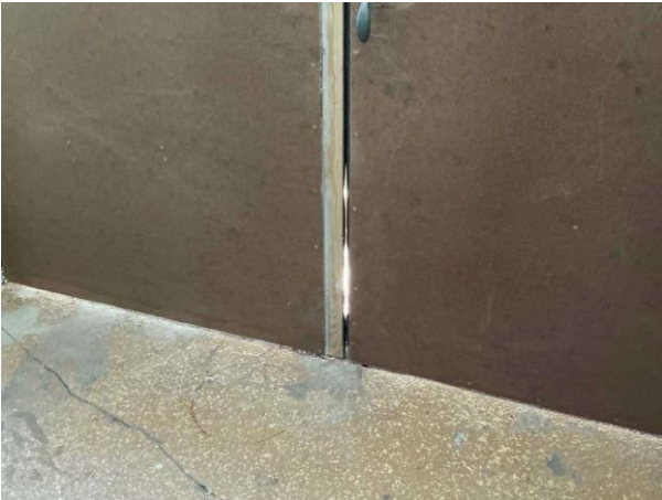
Bild 13: - Utvändigt, Garage, Putssläpp noterades i grundmurarnas nedre kant. Äldre gjutjärnsbrunn med rost Sprickor och Färgsl...
