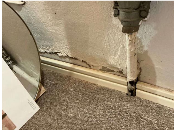
Bild 14: - Invändigt, Källarplan, Luftspaltsbildande golv med luftade socklar. Fuktgenomslag och lös färg på vägg i inbyggnad för el...
