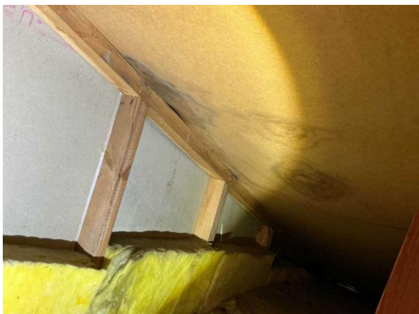
Bild 3: Utvändigt, Vind, Missfärgningar, spår av äldre läckage noterades på underlagstaket (bör hållas under uppsikt och v...
