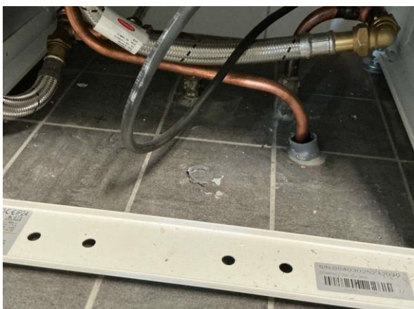
Bild 5: - Invändigt, Entréplan, Renoverat 2025 Kvalitetsdokument finns Det förekommer rörgenomföringar i golv annat än för avlopp...
