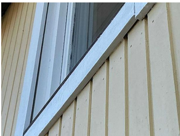
Bild 2: Utvändigt, Fönster, Äldre isolerglaskassetter. Isolerglas äldras och kan med tiden bli otäta. Det är inte alltid det ...
