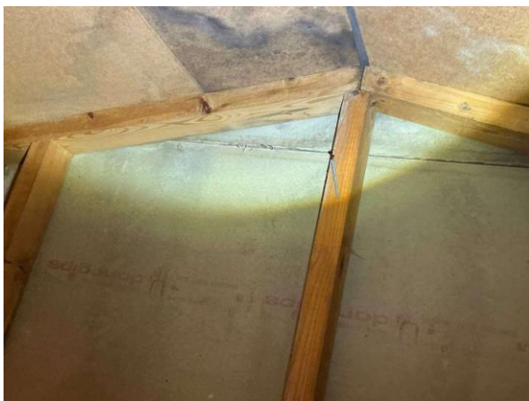
Bild 4: Utvändigt, Vind, Missfärgningar, spår av äldre läckage noterades på underlagstaket (bör hållas under uppsikt och v...
