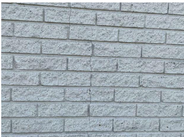
Bild 1: - Utvändigt, Fasad, Spricka i fasadtegelvägg noterades Träpanel monterad nära altan (kan medföra fuktuppsugning i trä...
