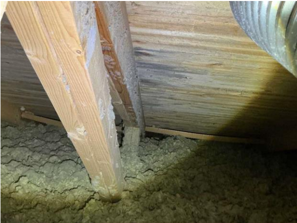
Bild 3: Utvändigt, Vind, Några blånader/missfärgningar noterades på underlagstaket (torra vid besiktningen) bör hållas und...
