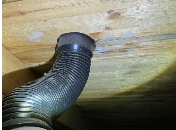
Bild 2: Utvändigt, Vind, Några blånader/missfärgningar noterades på underlagstaket (torra vid besiktningen) bör hållas und...
