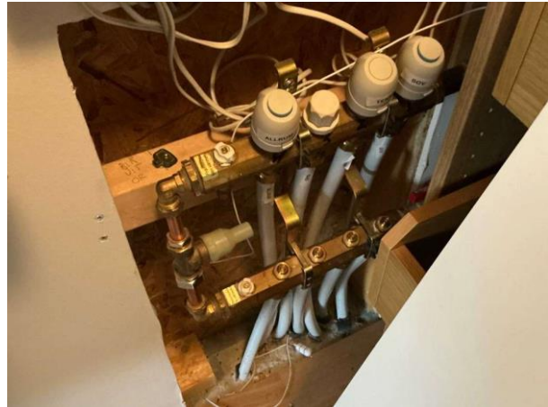
Bild 4: - Invändigt, Souterrängplan, Inbyggnad för golvvärme är inte utförd i tätt skåp med läckageindikering Spår av möss noterades
