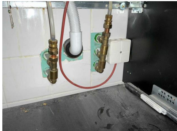
Bild 6: - Invändigt, Souterrängplan, Kvalitetsdokument saknas Lokalt golvfäll i dischzonen Tätskikt monterat över klämringen Brunnnsd...
