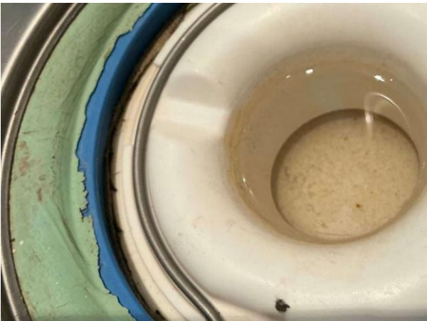
Bild 5: - Invändigt, Souterrängplan, Kvalitetsdokument saknas Lokalt golvfäll i dischzonen Tätskikt monterat över klämringen Brunnnsd...
