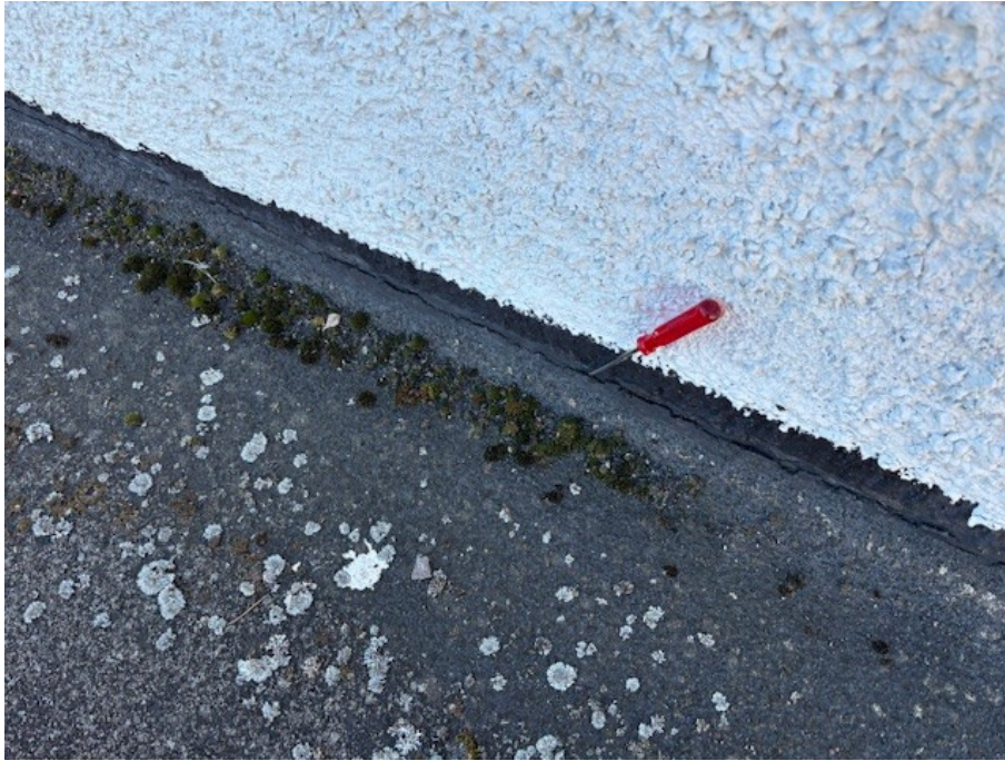
Sprickbildning i takpapp (garagebyggnad).
