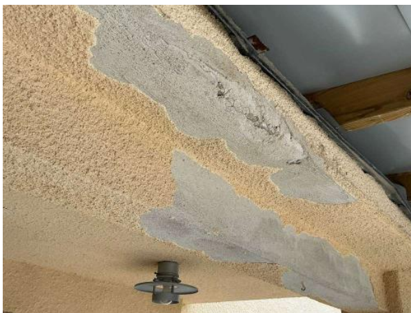
Bild 8: Utvändigt, Övrigt, Putssläpp under balkongen
