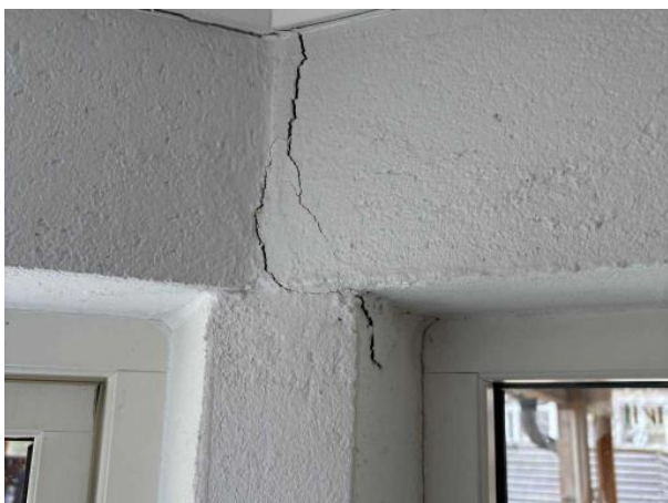
Bild 11: Invändigt, Entréplan, 2 sprickor noterades på väggar
