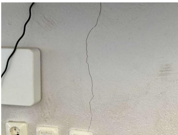
Bild 12: Invändigt, Entréplan, 2 sprickor noterades på väggar
