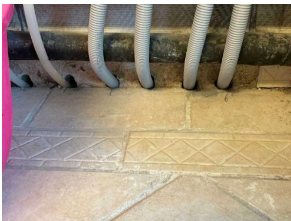
Bild 10: - Invändigt, Entréplan, Rör genomföring är inte tätade i vägg
