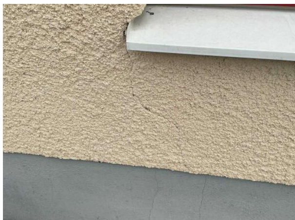
Bild 1: - Utvändigt, Fasad, Spricka finss putsen Hål noterades i fasaden
