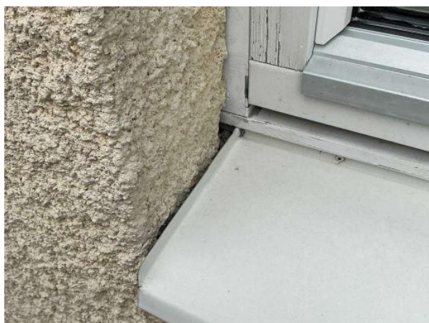
Bild 3: Utvändigt, Fönster, Otät fönsteranslutning (vid urhymningsdelen)
