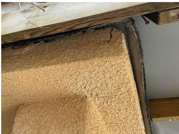
Bild 7: Utvändigt, Övrigt, Putssläpp under balkongen
