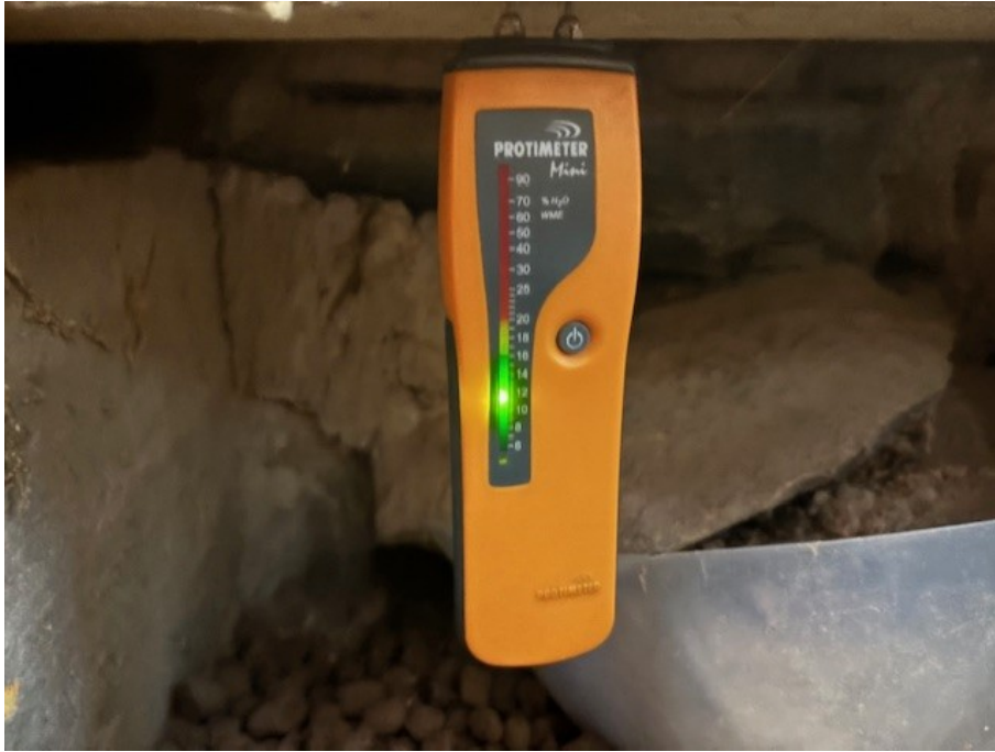
Fuktmätning i torpargrunden.
