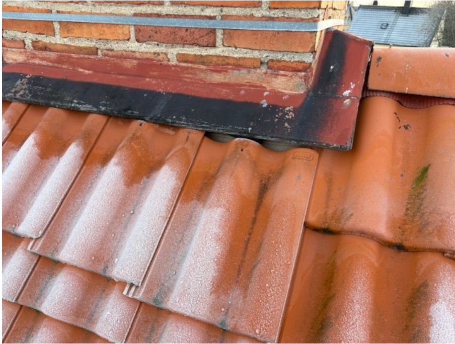
Takpannor som glidit ner vid murstocken, detta är åtgärdat 2026-01-09.
