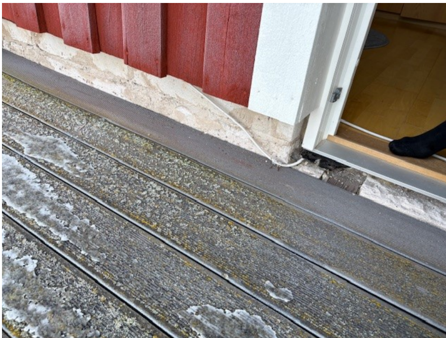
Ej färdigställt mot fasad och tröskel vid balkong, detta är åtgärdat 2026-01-09.
